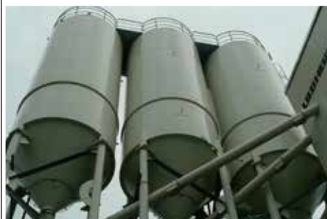
Fig. 1 Silobatterij met cirkelvormige stalen silo's op lokale steunkolommen. Fig. 1 Batterie de silos composée de silos circulaires en acier sur colonnes d'appui locales.
